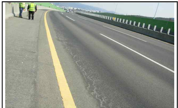
손상위치 : 교면포장(S3, 범물방향)
