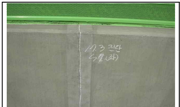
손상위치 : 방호벽(S7, 범물방향)
