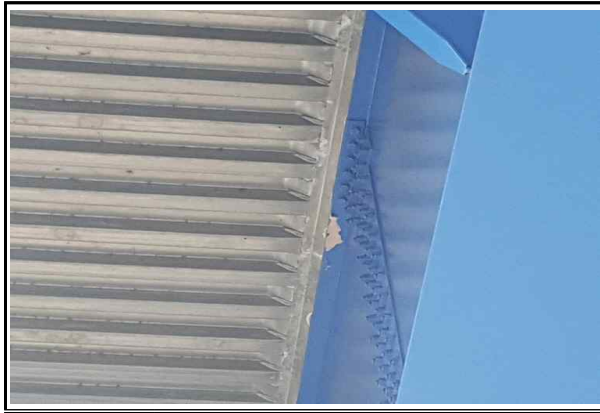
손상위치 : 거더 측면(S5-G2)
