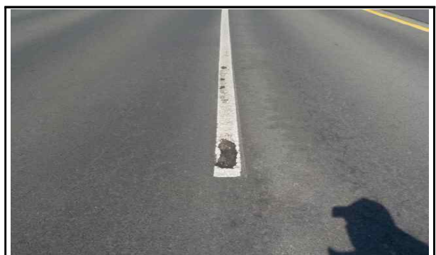
손상위치 : 교면포장(S3, 범물방향)
