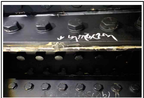
손상위치 : 내부 현장이음부 상부(S3, G1)
