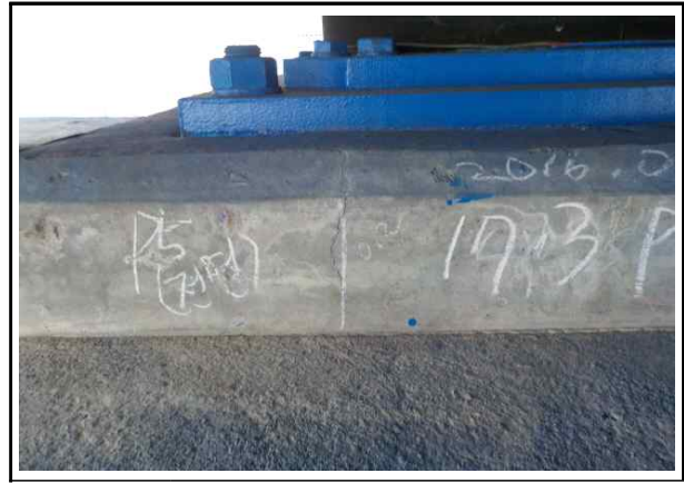
손상위치 : 받침장치(P5, SH2)
