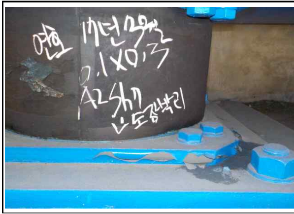
손상위치 : 받침장치(A2, SH7)
