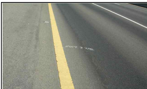
손상위치 : 교면포장(S5, 안심방향)
