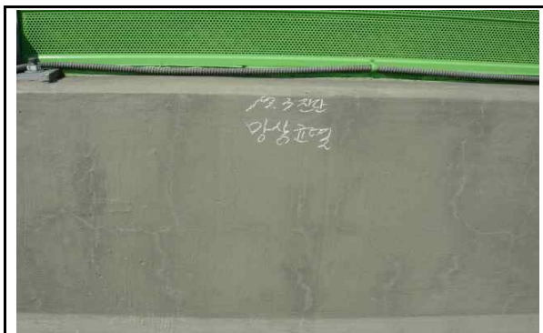
손상위치 : 방호벽(S2, 범물방향)
