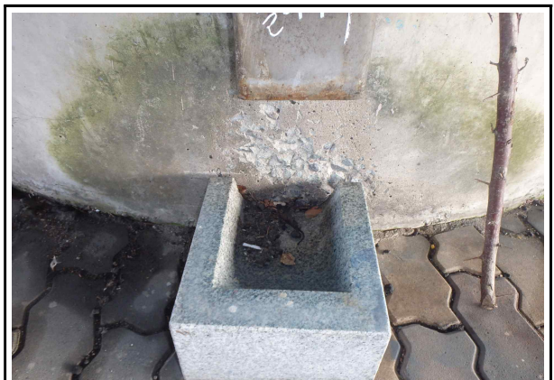
손상위치 : 교각(P2, 기둥부)
